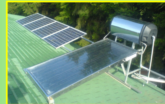
Sistema de generación Aislado 1,24 KWp y calentamiento de agua, Casa Habitacional en Apaneca, Departamento de Ahuachapán
