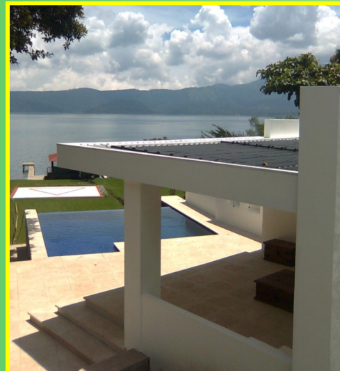
Sistema de calentamiento de agua para piscina, Casa recreacional Lago de Coatepeque
