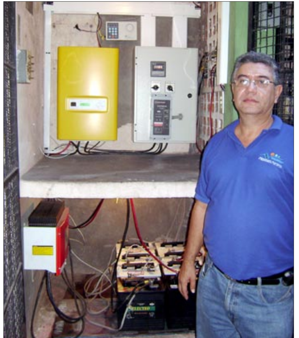
Ingeniero Roberto Bonilla, gerente general de Suministros Eléctricos y Electrónicos, junto al sistema generador de energía solar del edificio de su empresa.
